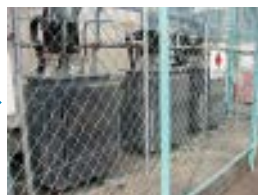
更新後のトランス
