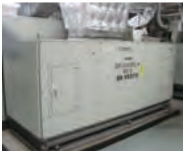
クリーンルーム用空調機（内調機）
