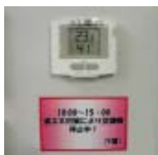
空調機停止の表示板
